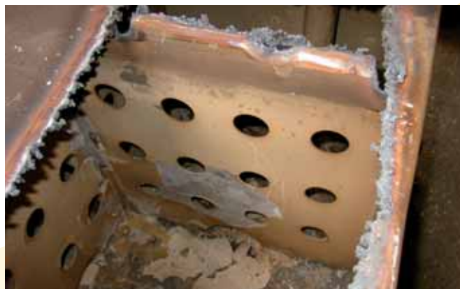
Sediment och föroreningar på vägg och botten av vattentankar – Källa: ISPESL.
