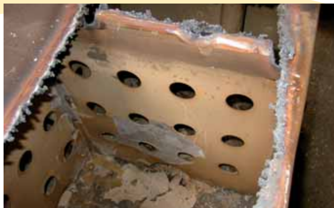
Sedimento e detritos nas paredes e no fundo do tanque de água — Fonte: ISPESL.
