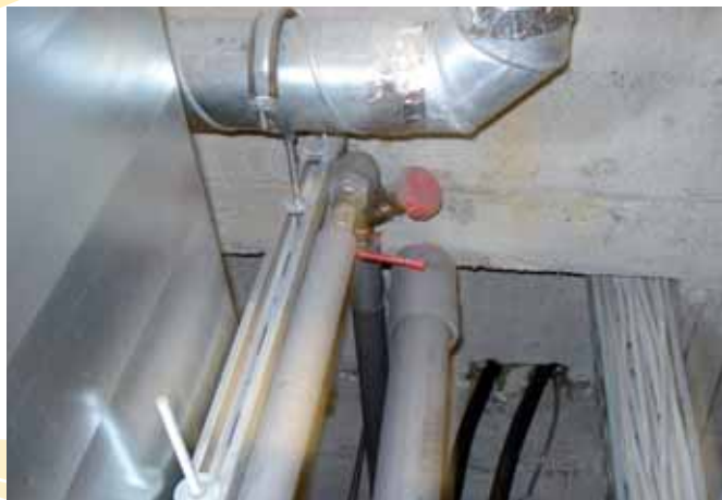
Circuito fechado oculto num sistema de circulação de água quente que proporciona espaço para o crescimento da Legionella — Fonte: OMF1.
