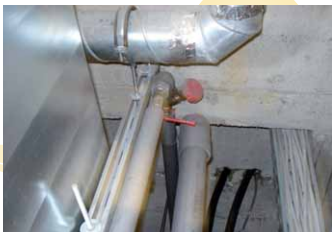
Boucle fermée cachée dans le système de circulation de l'eau chaude favorisant le développement de Legionella — Source: OMF1.
