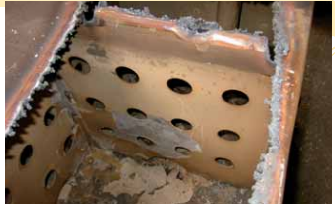
Vesisäiliön seinillä ja pohjaan kertyvä sedimentti ja jätteet. Lähde: ISPEL.
