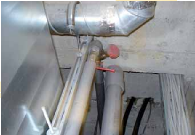
Piilotettu suljettu piiri kuumun veden kiertojärjestelmässä, joka tarjosi kasvualustan Legionella -bakteerille. Lähde: OMF1.
