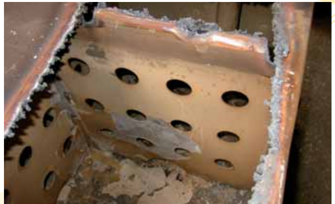
Ablagerungen und Verunreinigungen an den Wänden und am Boden eines Wasserbehälters – Quelle: ISPESL.
