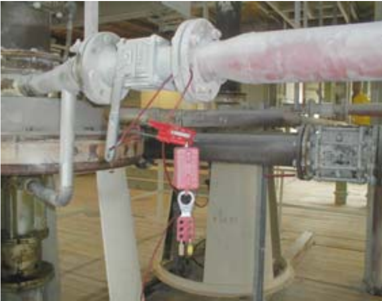
Durch die Lockout-Vorrichtung an der Rohrleitung wird eine versehentliche Freisetzung von Heißdampf verhindert. Das Masterlock (Hauptschloss) im roten Kasten sichert die Arretierung. Das Masterlock kann erst entfernt werden, wenn die beiden Mitarbeiter ihre persönlichen Schlüssel abgezogen haben.
