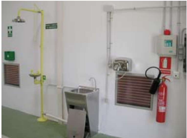
Von links nach rechts: Erste-Hilfe-Ausstattung, Augenspülvorrichtung, Duschen, Waschbecken und Handtrockner, CO 2 -Feuerlöscher und Alarmanlage
