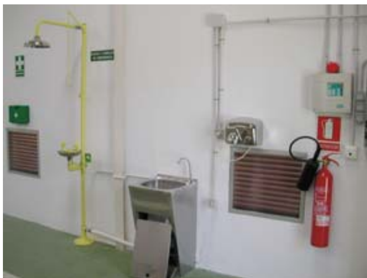
De gauche à droite: trousse de premiers secours, bain oculaire, douches, évier et sèche-mains, extincteur CO 2 et alarme.
