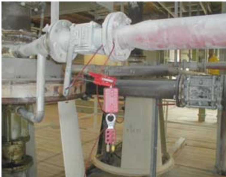
Verrouillage sur une tuyauterie afin d'éviter un dégagement accidentel de vapeur chaude. Le verrou de sécurité principal dans la boîte rouge bloque la fermeture. Le verrou de sécurité ne s'ouvre que si deux ouvriers retirent leurs clés personnelles.
