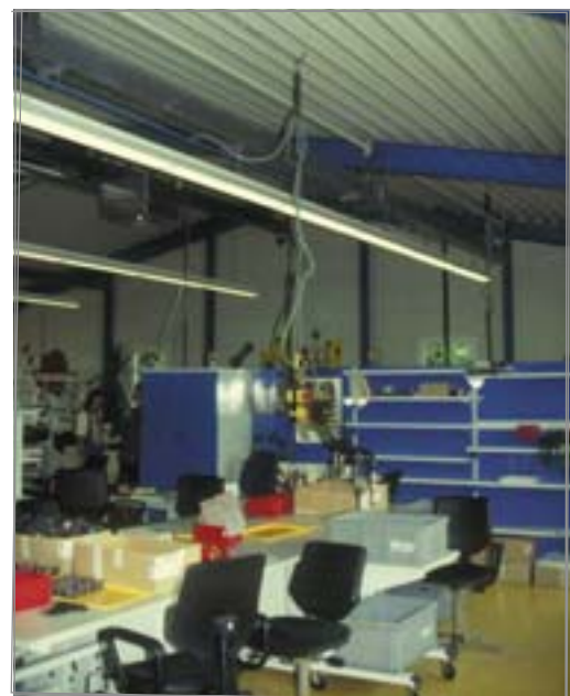
Abbildung 4: Metallwerkstatt mit Schall absorbierender Stahltrapezblechdecke
