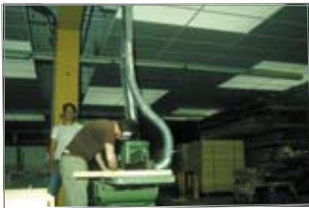
Abbildung 1: Abgehängte Schall absorbierende Deckenfläche in der Holzbearbeitungswerkstatt
