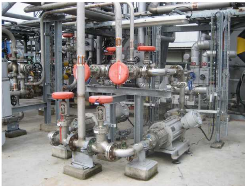
Obrázek 1: Složité systémy, jako tento v podniku BASF, mohou zvýšit rizika, která vznikají při údržbě
