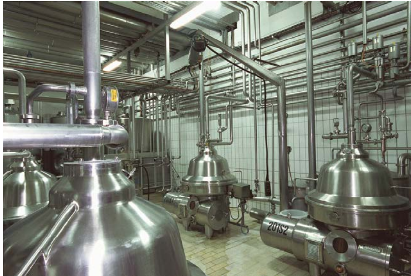
Abbildung 2: Anlage in einer Käserei
