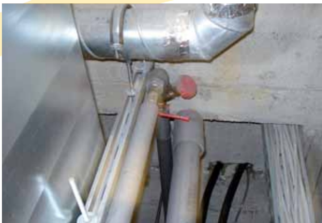
Skjulte lukkede sløyfer i sirkulasjonssystemet for varmtvann som ga rom for vekst av legionella-bakterier — kilde: OMF1
