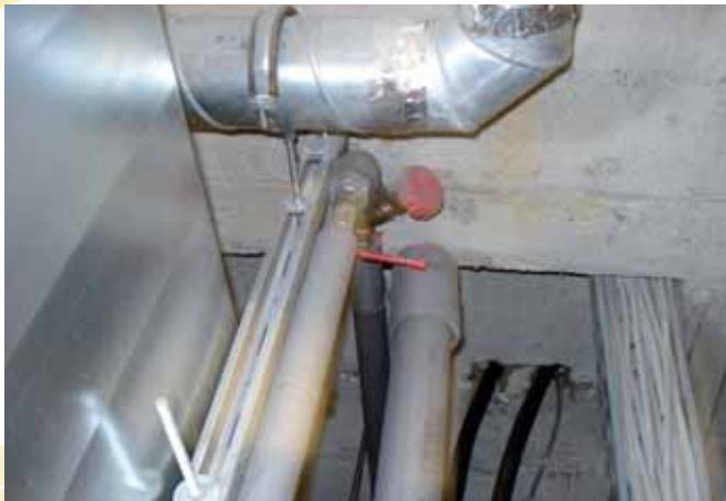
Verborgen gesloten circuit in warmwatercirculatiesysteem waarin Legionella kon groeien — Bron: OMFI.
