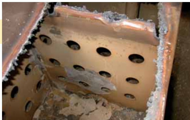
Sediment u trab fuq il-ġnub u fil-qiegħ tat-tank tal-ilma — Sors: ISPEL
