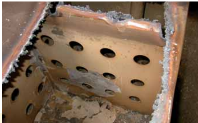
Nuosėdos ant vandens rezervuaro sienų ir dugno (Šaltinis: ISPESL)
