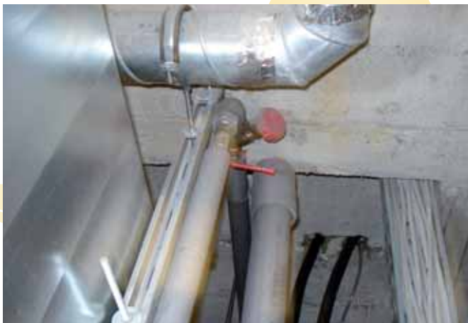
Falín lokuð hringrás í heitavatnskerfinu bjó til kjöraðstæður fyrir vöxt legionellu - Heimild: OMF
