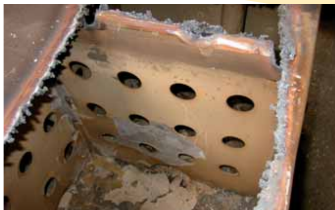
Sedimento y escombros en paredes y fondos de depósitos de agua. Fuente: ISPESL.
