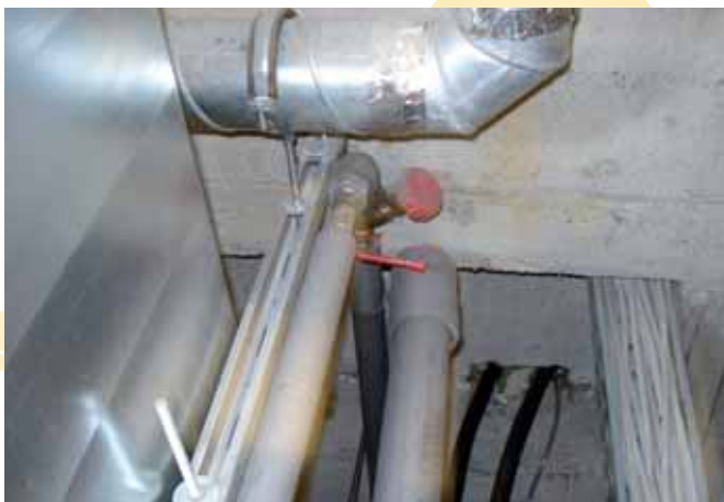
Sistema de circuito cerrado oculto de circulación de agua que permitía el desarrollo de la legionelosis. Fuente: OMF1.
