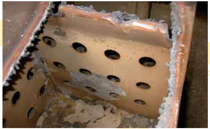
Ίζημα και υπολείμματα στα τοιχώματα και στον πυθμένα δεξαμενής νερού — Πηγή: ISPEL
