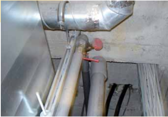
Μη εμφανές κλειστό κύκλωμα στο σύστημα κυκλοφορίας θερμού ύδατος που ευνοούσε την ανάπτυξη λεγεωνέλλας — Πηγή: OMF1
