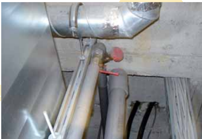
Skjult lukket sløjfe i varmtvandssystemet, som gav anledning til fremvækst af Legionellabakterier — Kilde: OMFI.
