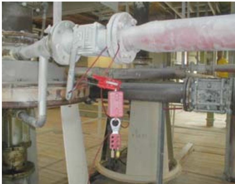
Verrouillage sur une tuyauterie afin d'éviter un dégagement accidentel de vapeur chaude. Le verrou de sécurité principal dans la boîte rouge bloque la fermeture. Le verrou de sécurité ne s'ouvre que si deux ouvriers retirent leurs clés personnelles.
